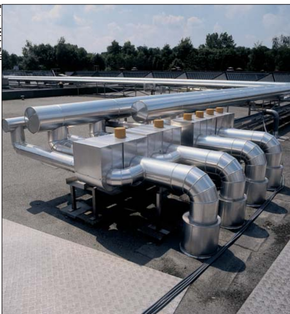
Aan- en afvoerleidingen voor terugwinning van restwarmte (Elite Salades & Snacks BV).
